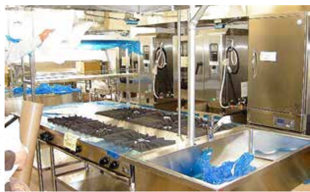
搬入されたこだわりのガスレンジ
